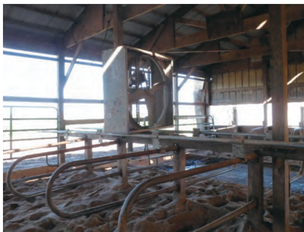
写真4 気流を作るために無理やり設置した換気扇（米国）
