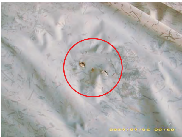
写真3 シートのピンホール
