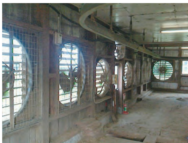
写真5 トンネル換気
