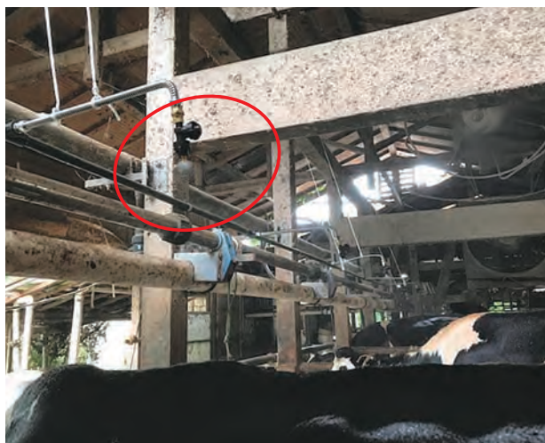
写真5 ソーカーシステム稼働の様子 (A牧場)
