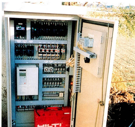
写真3 微生物に最適なキルン回転を制御する主操作盤
