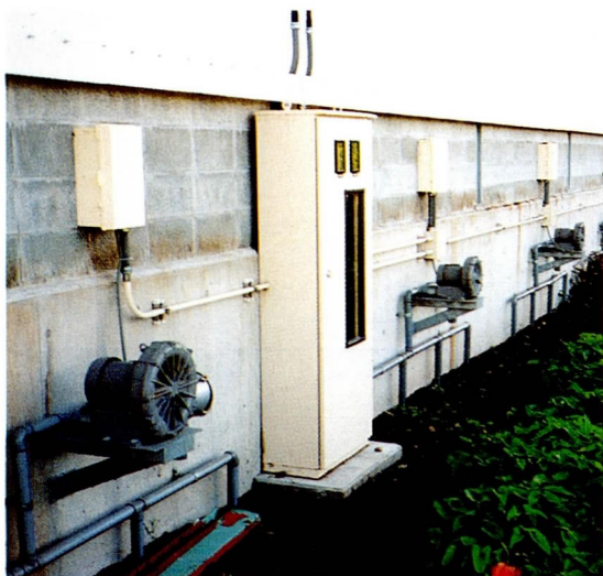
写真4 堆肥舎の通気装置
