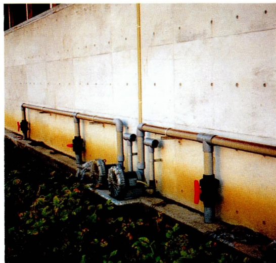
写真2 堆肥舎の通気装置
