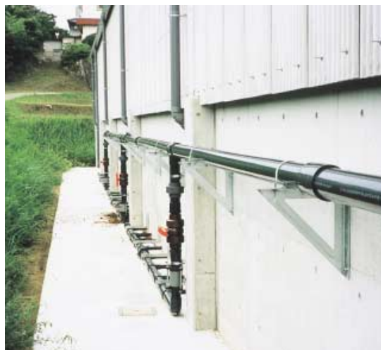
写真7 主配管と枝管の設置例
