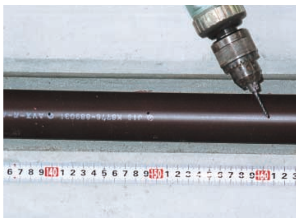
写真6 ブロウ配管の穴あけ例
