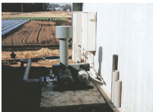
写真5 圧力の高いロータリーブロウ
