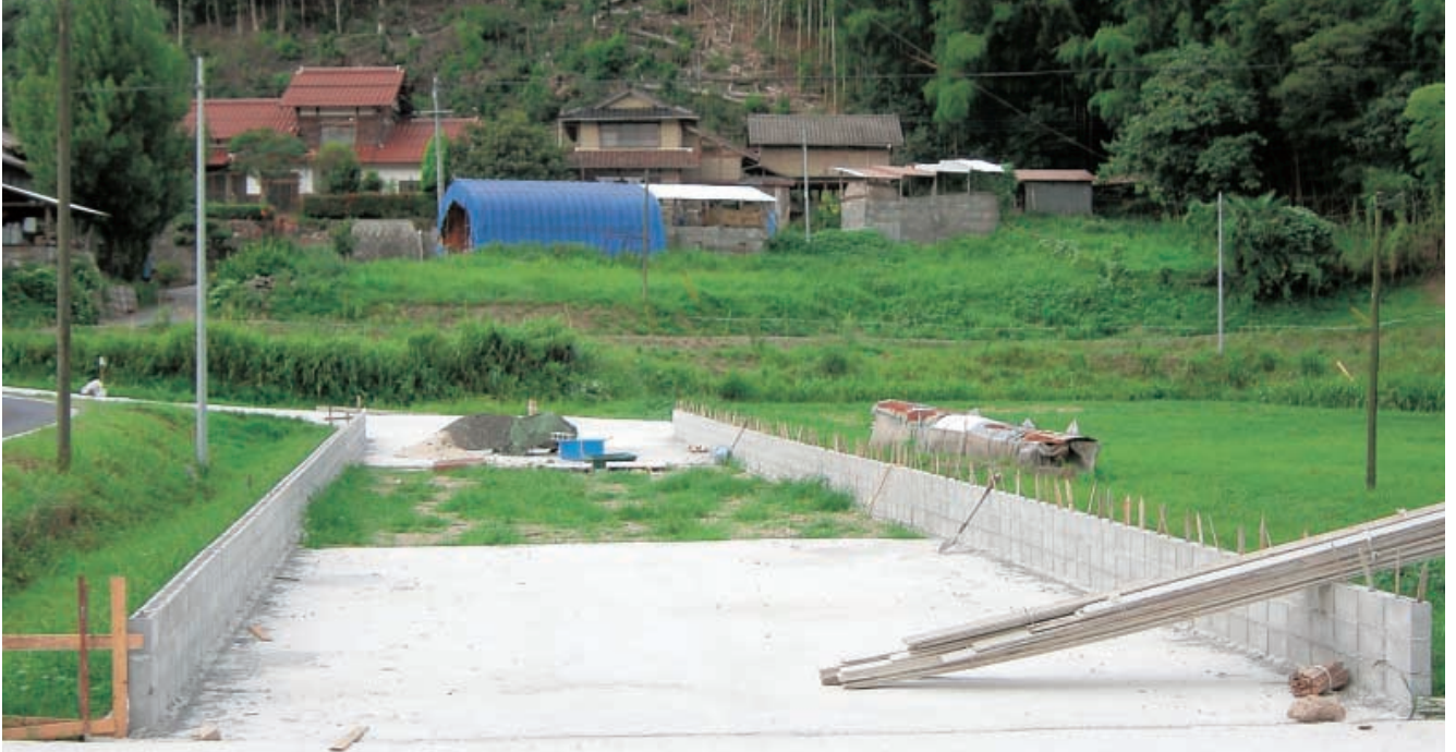
写真3 乳用牛成牛30頭規模の農家。休耕水田に幅7m、長さ42.5mのハウスを建築中。進入路、投入口や取り出し口付近をコンクリートとし、中央は遮水シート敷きの土間仕上げ。壁際まで使えるようブロックを3段積み、ブロックの穴へパイプを差し込みハウスを建てる。
