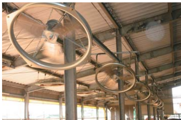
写真3 ベッド上に設置した送風機
