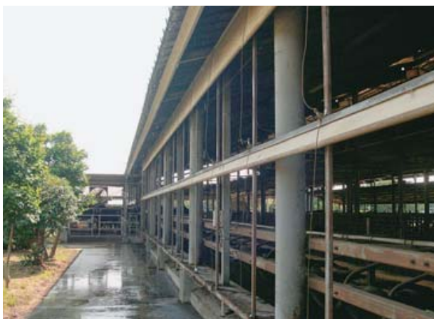
写真1 牛舎屋根の散水システム
