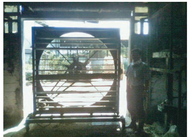
写真4 乾乳牛舎の大型ファン
