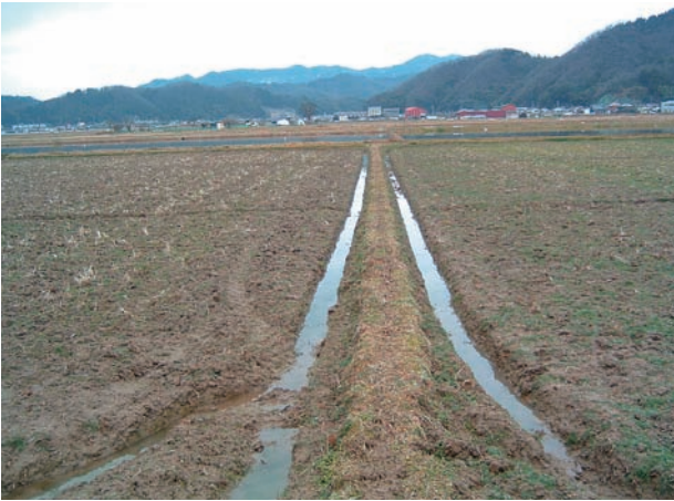
写真3 額縁明渠による排水対策
