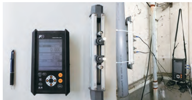
写真1. 超音波水量計（左）と設置例（右）
