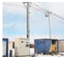
敷地内に自前の変電施設を持ち、高圧電力を変換して使用。停電時用の自家発電装置もある
