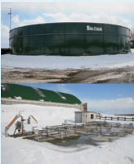
ふん尿を溜めてスラリーとして使う肥培かんがい施設。有機物の分解を促進させ、冬期間は調整槽で貯蔵する
